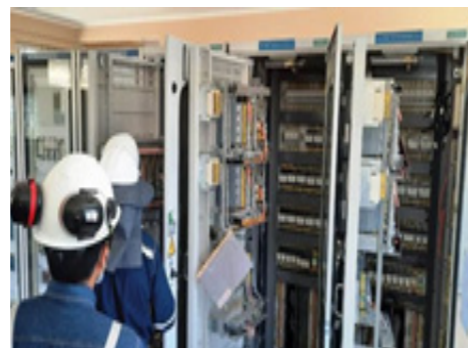
Verificación a panel de Control, Intercov
